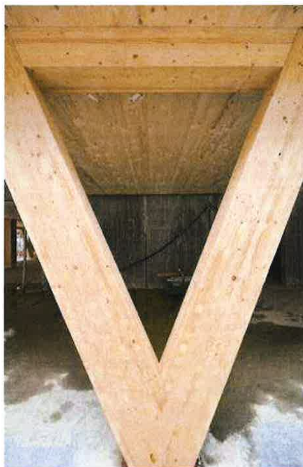
▷ Détail de la structure en bois innovante de l'immeuble de bureaux Montoyer 10 - Bruxelles CBD (BE)
